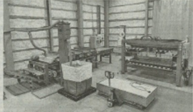
太陽光パネルリサイクル設備
