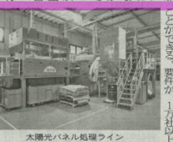
太陽光パネル処理ライン
